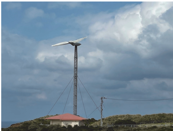
可倒式風力発電設備
