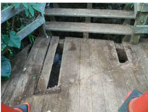
Bライン起点床板腐食崩壊状況
