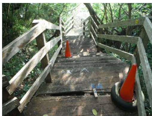
NO. 2付近床板の腐食崩壊状況
