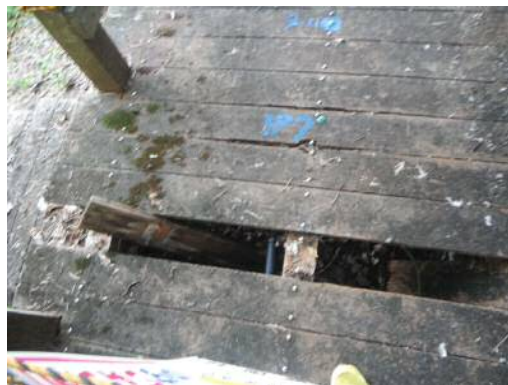
IP#7付近床板腐食崩壊状況
