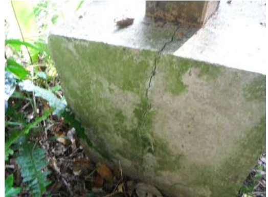
IP#1下付近の基礎に亀裂
