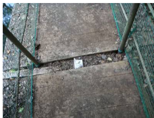
NO. 3+10.0付近渡り橋床板腐食崩壊状況
