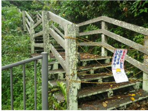
柱及び手すりにはカビが定着
