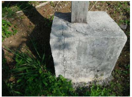
日当たりが良好でも亀裂あり
