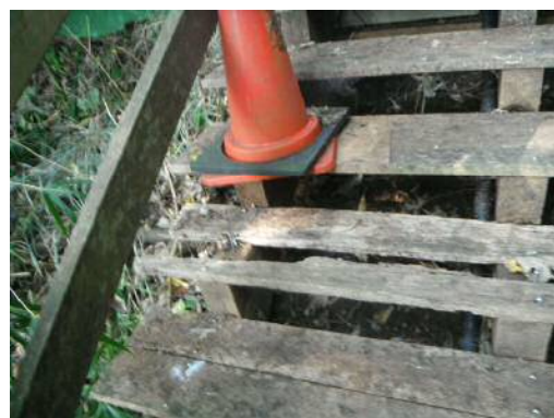
NO. 5付近階段踏み板腐食状況
