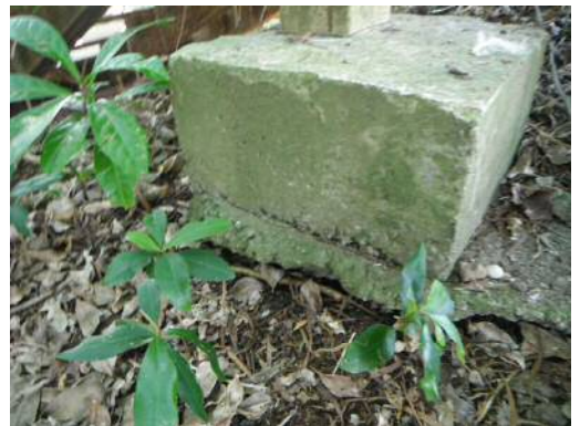
斜面地の洗掘で基礎の浮き上がり
