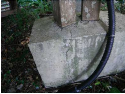
IP#1下付近の基礎に亀裂
