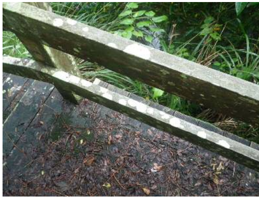
手すりにカビ、床にコケが定着
