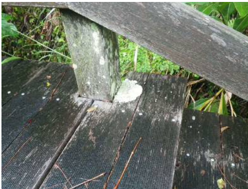
柱及び手すりにはカビが定着
