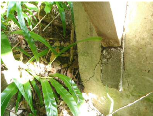
支柱かすがい部に亀裂
