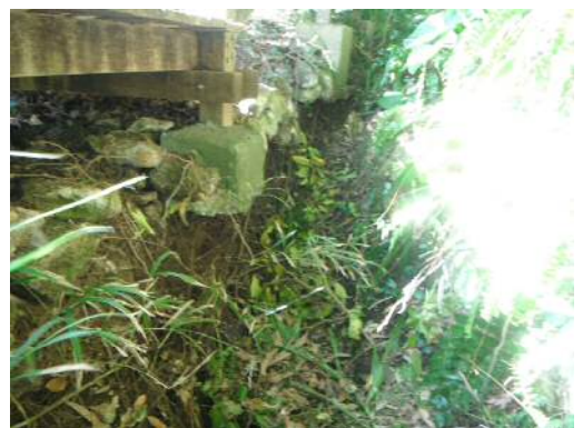
素掘り水路の洗掘で基礎の浮き上がり
